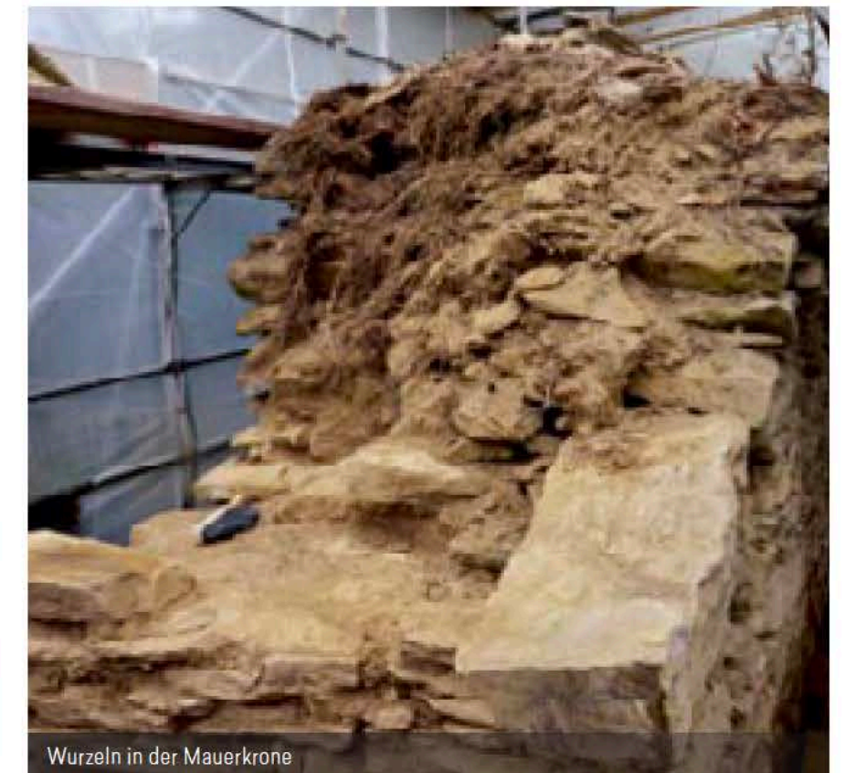
Wurzeln in der Mauerkrone
